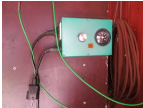
Termostat med termometer på röskåp
